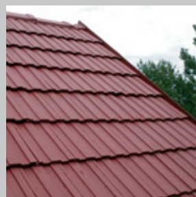
betonová krytina po nátěru
